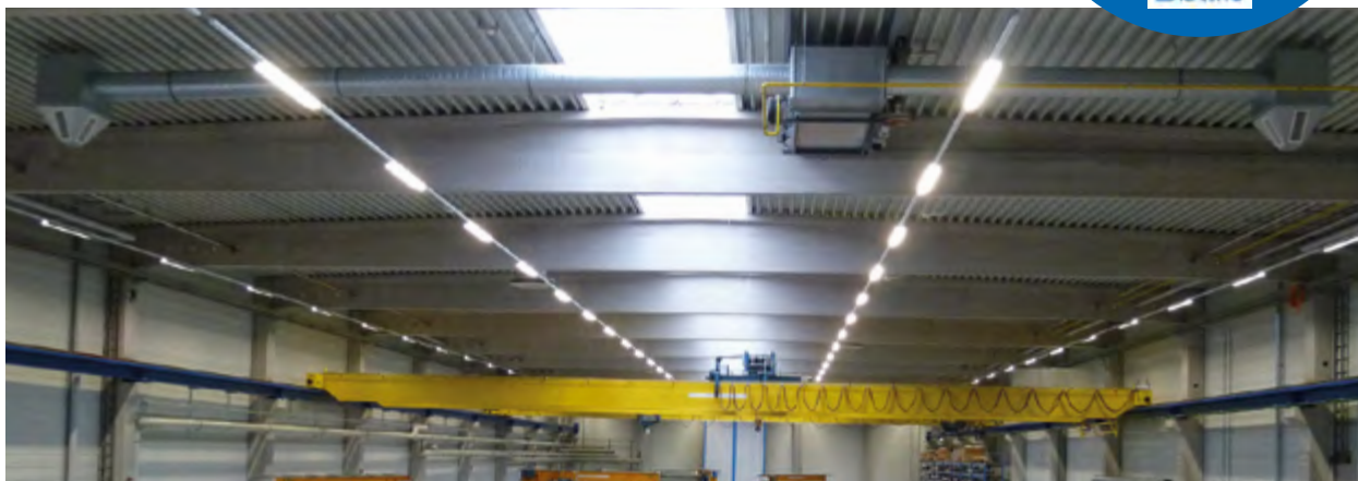
Feinmechanikproduktion: Beheizung mit Weitwurf-Ausblasköpfen. Wärmerückführung mittels Deckenventilatoren.
