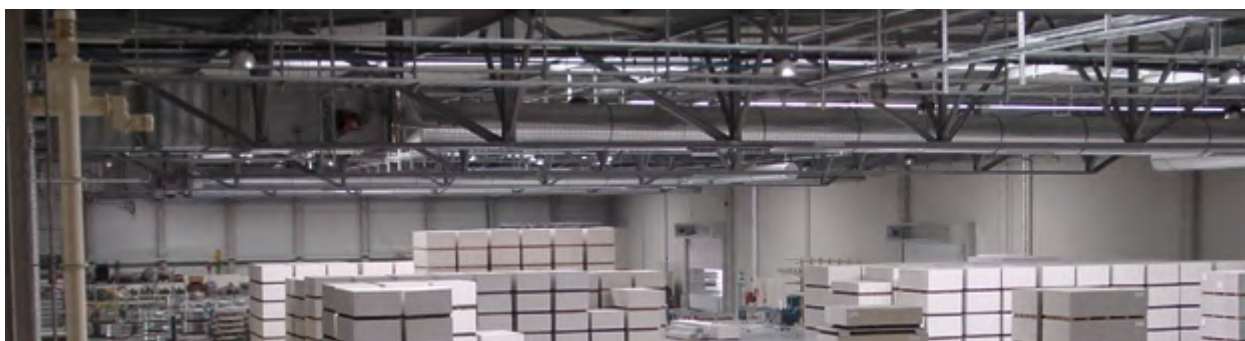
Rigipslager: Beheizung mit optionaler Frischluftbeimischung.
