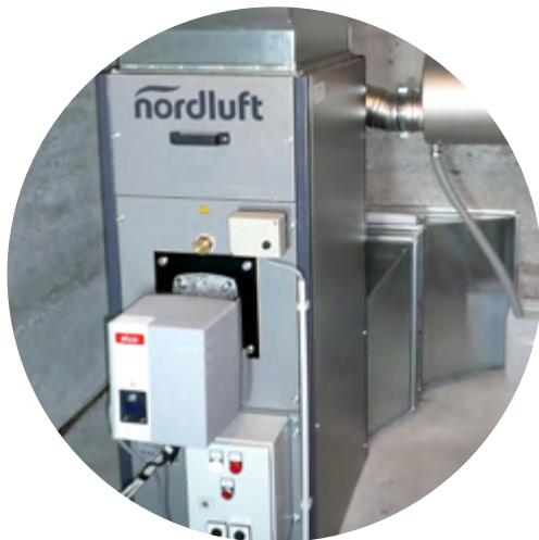
Frischlufteinlass eines NL-A WO
