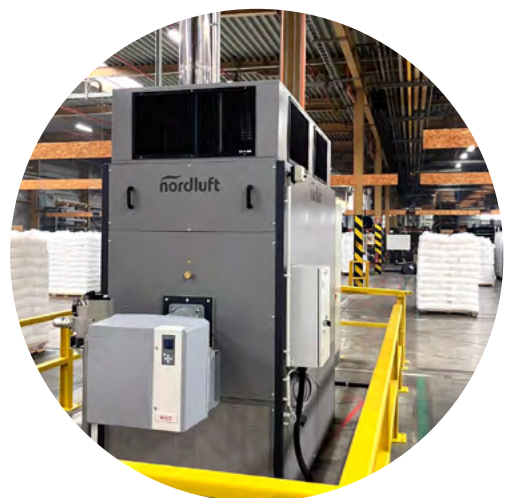
Warmfluterzeuger (48.300 m 3 /h, 600 kW) mit Umluftfilter zur Beheizung und Belüftung der Lagerhalle eines Automobilzulieferers.
