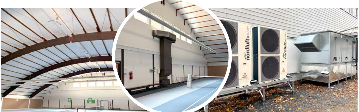
Beheizung und Belüftung einer 2-Feld-Tennishalle mit einem wetterfesten EcoWP 125 (18.300 m 3 /h), ausgestattet mit 90 kW Wärmepumpen- und 30 kW Stromspitzenlasterzeuger.
