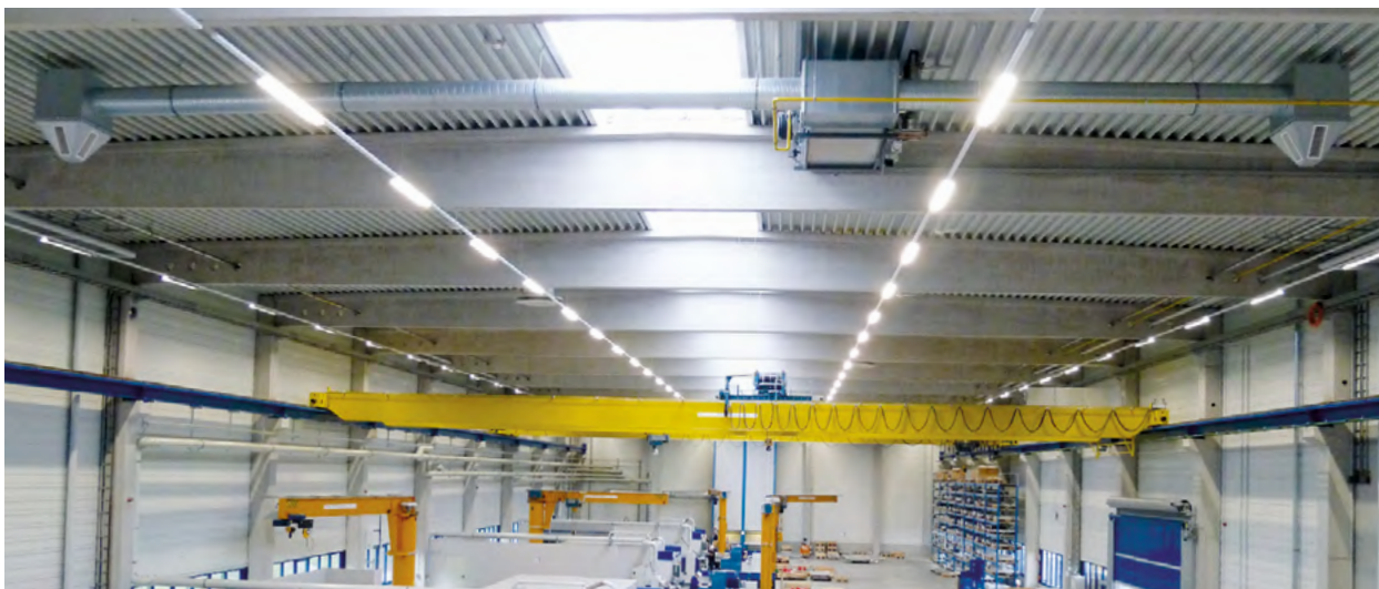
Feinmechanikproduktion: Beheizung mit Weitwurf-Ausblasköpfen. Wärmerückführung mittels Deckenventilatoren.
