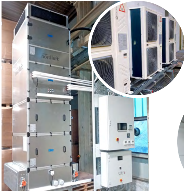
Wärmepumpenheizung (3-fach-Kaskade) mit Stromdirektheizung zur Spitzenlastabdeckung
