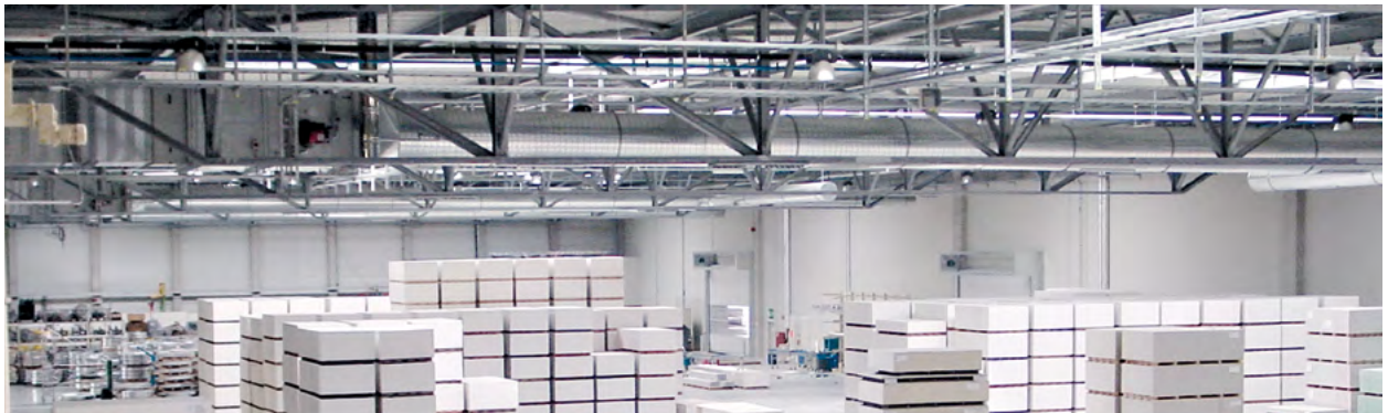
Rigipslager: Beheizung mit optionaler Frischluftbeimischung.
