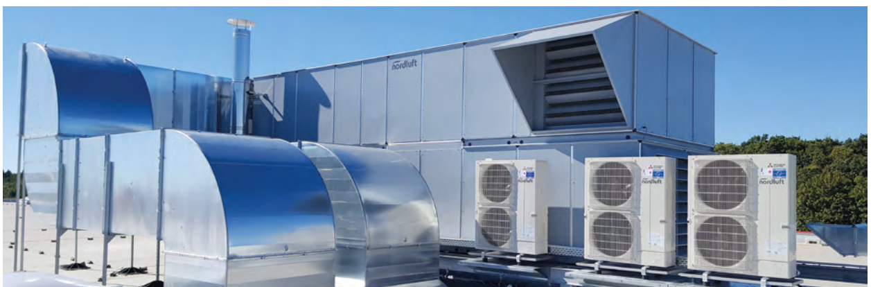
Beheizung, Kühlung und Belüftung eines Möbelmarktes. EcoKomfort (44.000 m 3 /h) mit Wärmerückgewinnung.
