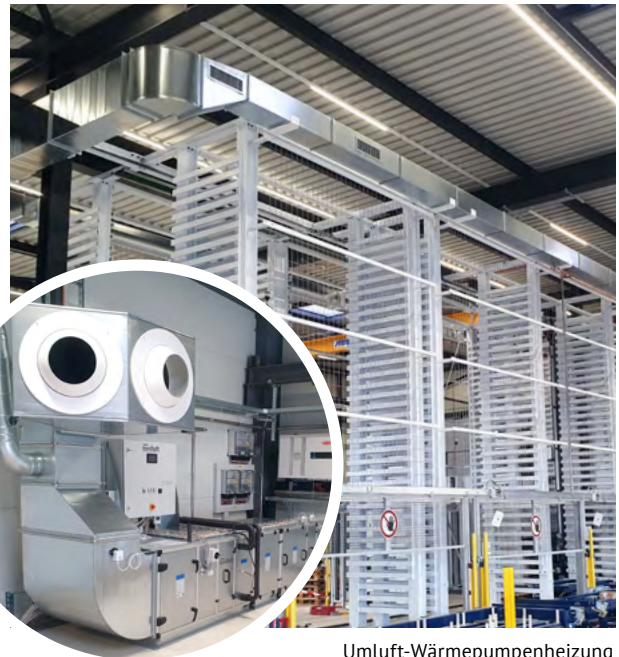
Umluft-Wärmepumpenheizung für einen Metallbearbeitungsbetrieb
